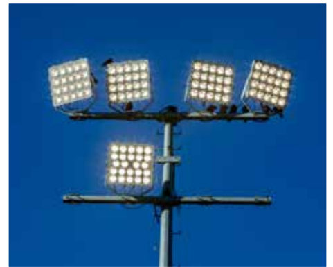
Focos led instalados en el campo 2 de hockey.
